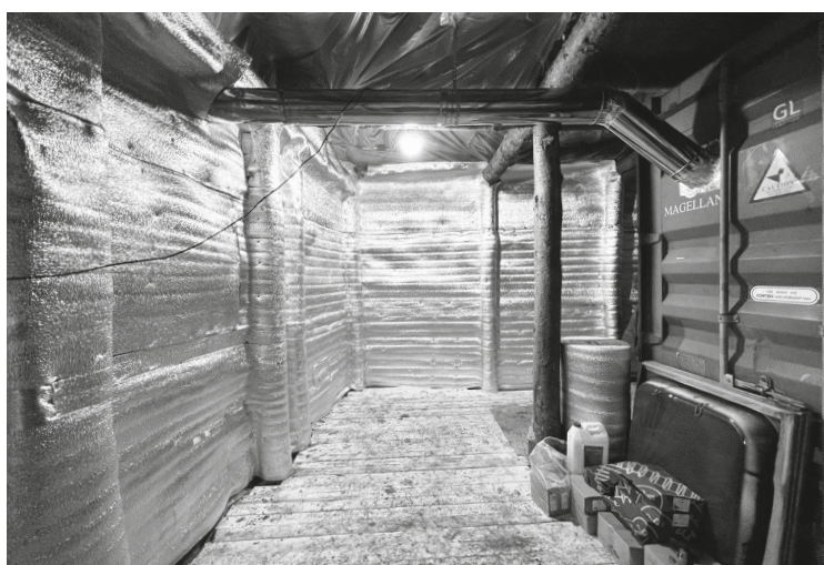
Так сейчас выглядят стены подземного ФАПа
